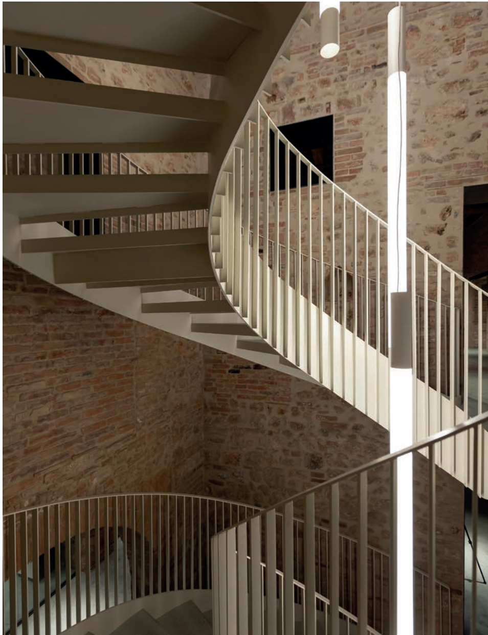
All the stringer of staircase have been calendered to size I cosciali delle scale sono stati tutti calandrati
